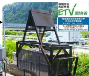
水車・発電機 ▶
