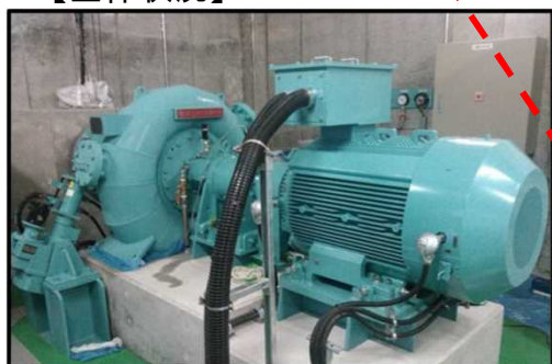
▲【水車及び発電機】
