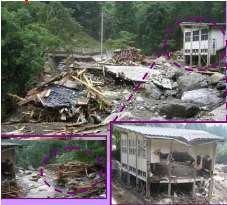
全壊した「柏川集会所」 全壊した「社会教育センター」
