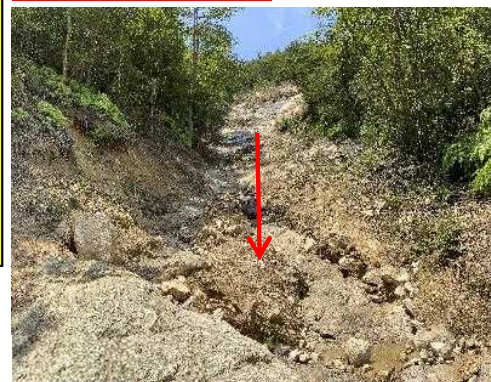
土砂流出状況
