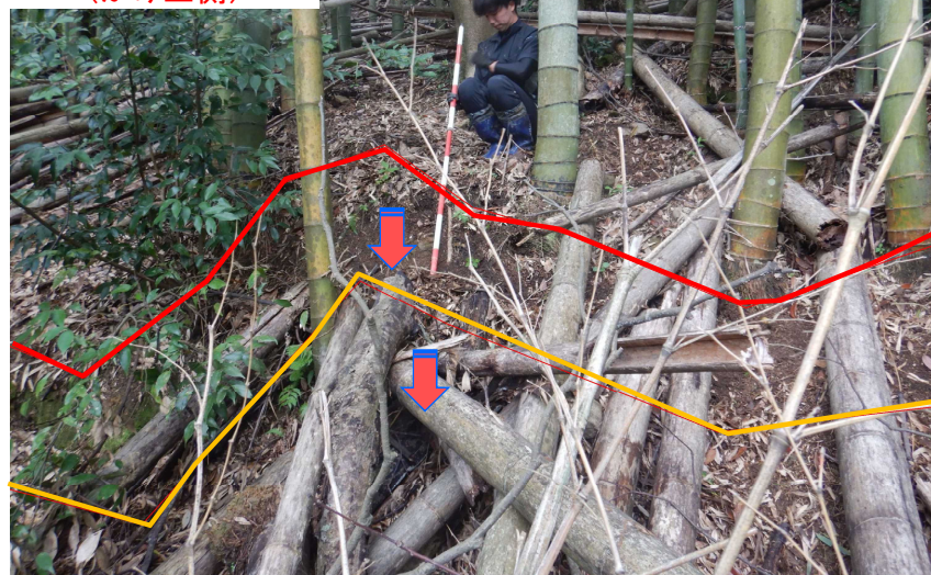
段差(亀裂)発生状況 (がけ上側)
