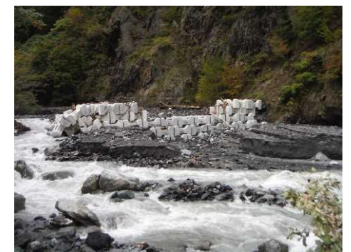
令和元年10月12日台風19号 による被災状況
