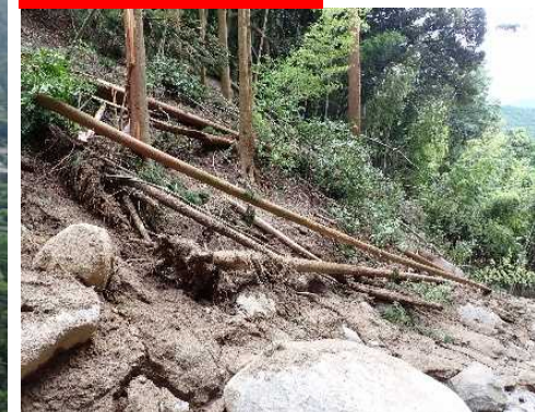
溪流土砂堆積状況
