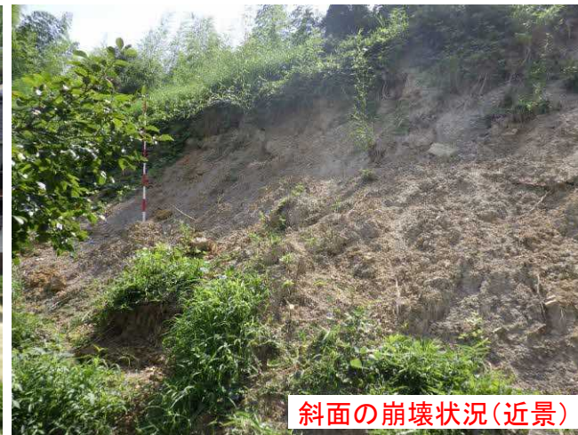
斜面の崩壊状況(全景)
