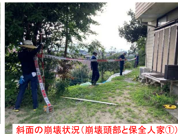
斜面の崩壊状況(全景)
