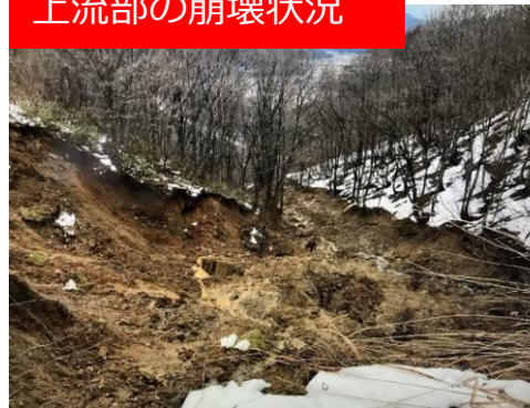
上流部の崩壊状況
