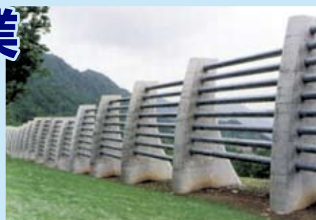
雪崩防護工 (新潟県中魚沼郡津南町)
