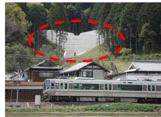
【交付金事業】砂防堰堤整備(兵庫県)
