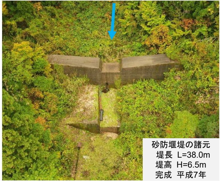
土石流発生前 (R3.10.26)
