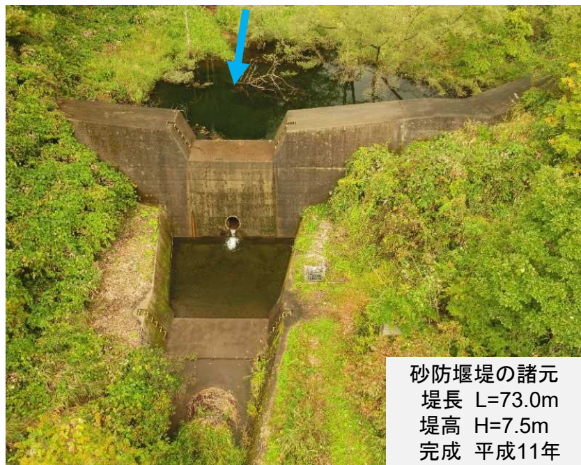
土石流発生前 (R3.10.26)
