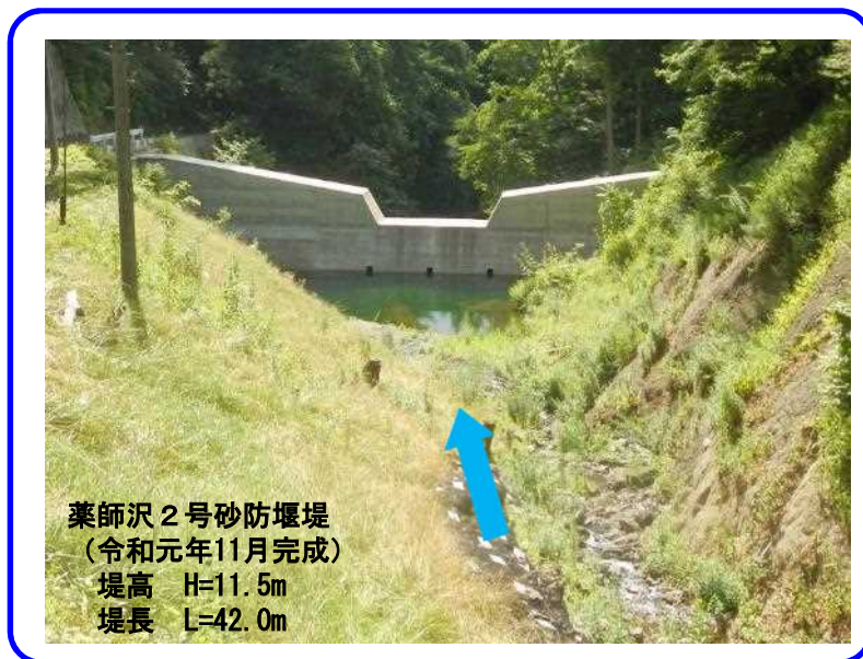
土石流発生前 (R3年10月)
