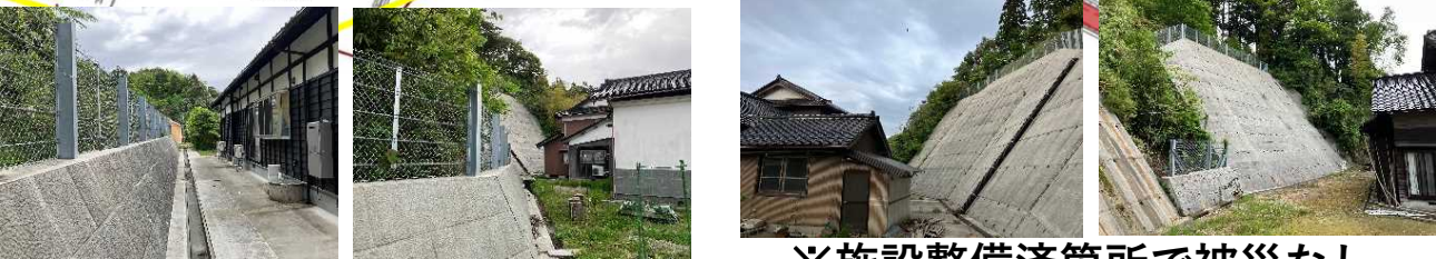
※施設整備済箇所では被災なし
