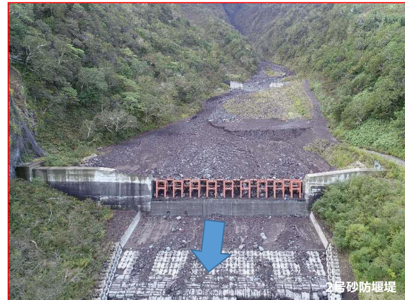
土石流発生後(令和5年10月2日 撮影)
