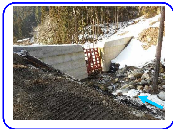
土石流発生前 (R4年3月)
