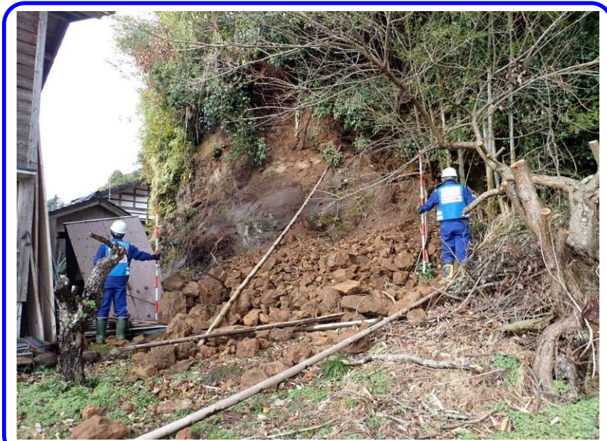
①斜面崩壊発生状況【R6.1.12撮影】 《未対策箇所》
