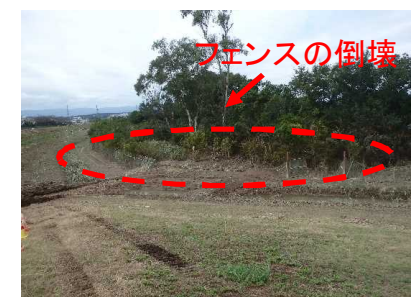
フェンスの堤内地側への倒壊
