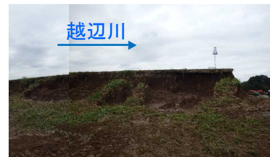
↑川裏部への洗掘
