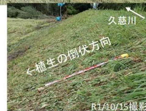
裏のり面の植生の倒伏状況
