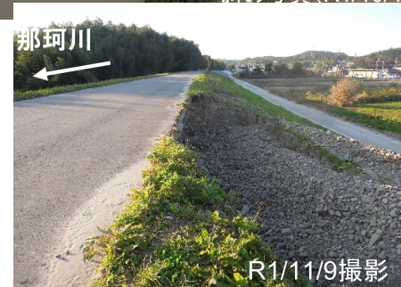
川裏側の侵食
