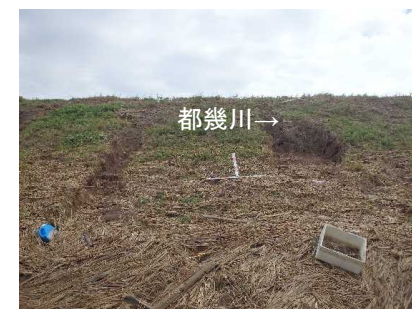
川裏部の洗掘
