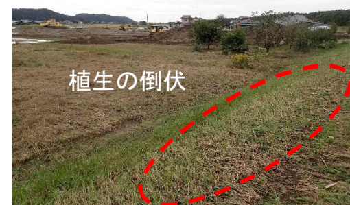
川裏のり面の植生倒伏の状況
