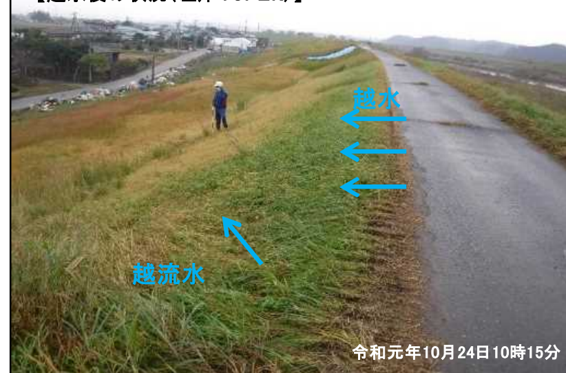
【越水後の状況(左岸16. 2k)】
