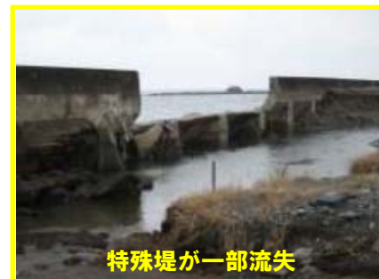
特殊堤背後が大きく侵食
