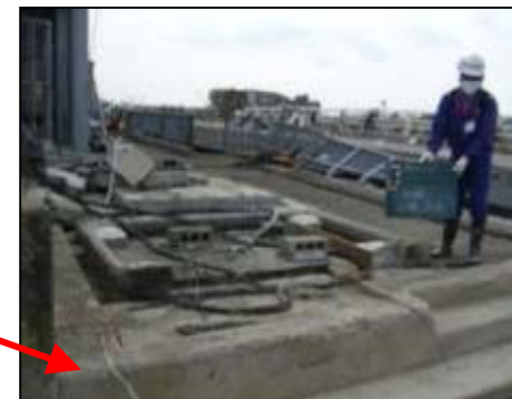
＜発電機室の流失＞
