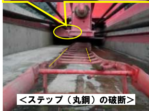
< 2号右岸階段損傷 >
