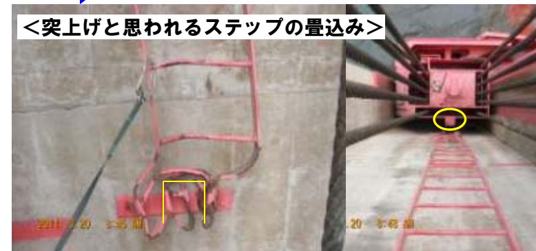
< 5号ゲート右岸階段の損傷 >
