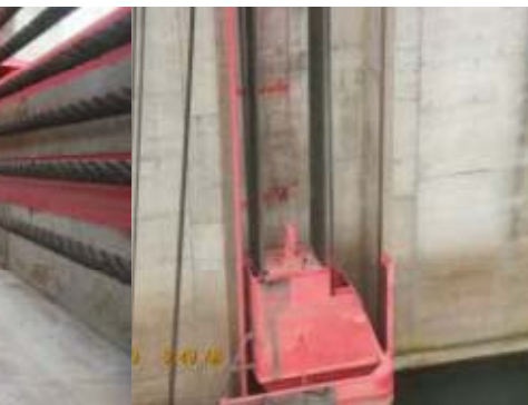
< 5号ゲート右岸階段の損傷 >
