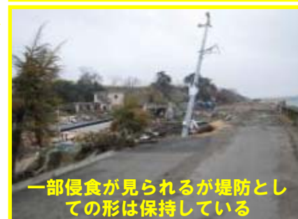
特殊堤が一部流失
