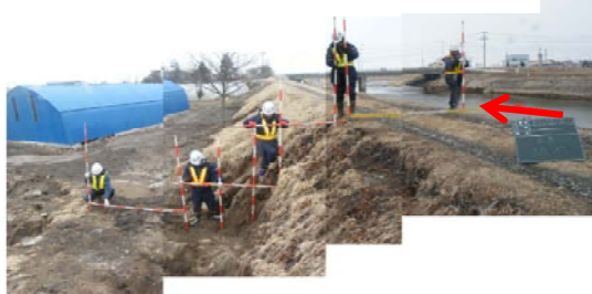
川裏側の法尻侵食
