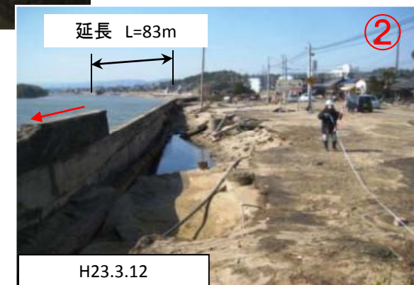
②背面(堤内地)吸出し
