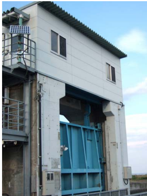
機側操作盤を設置している 堰柱上屋
