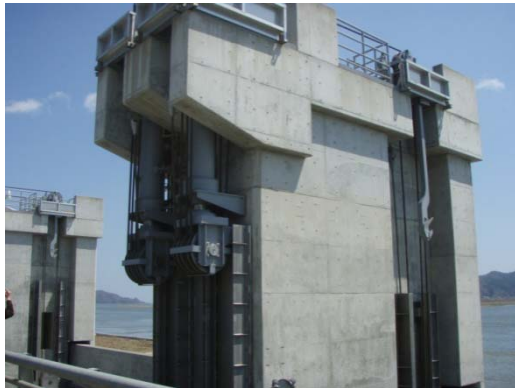
機側操作盤を設置している堰柱
