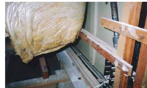
平成12年9月東海豪雨の被害状況
