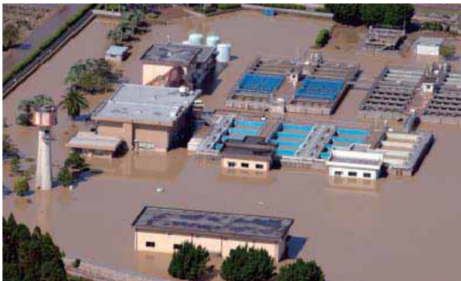
冠水して一面泥水に浸った富吉浄水場(宮崎市富吉)
