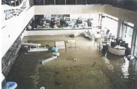
西枇杷島町の庁舎浸水状況
