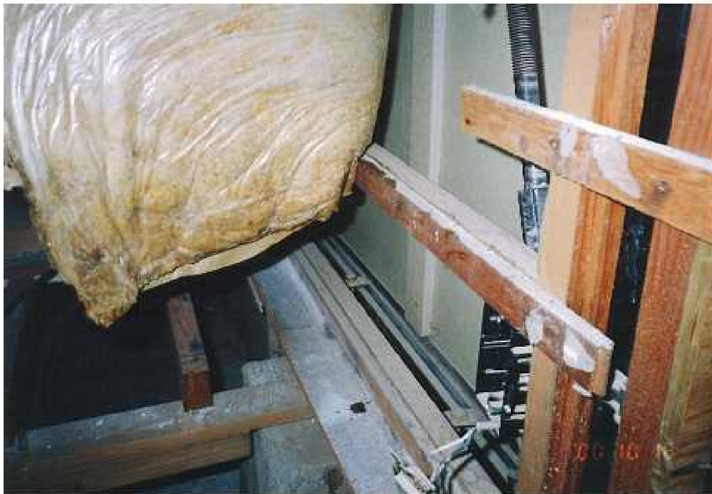
H12東海水害で被災した家屋の断熱材
