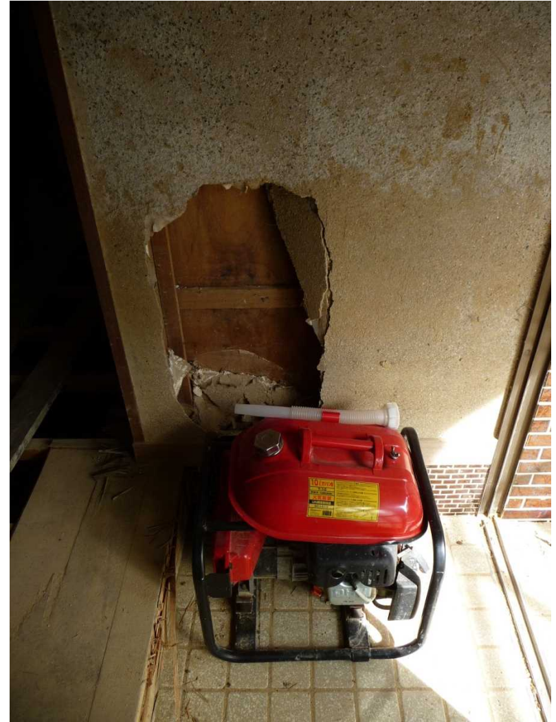
浸水により損壊した内壁(石膏ボード)
