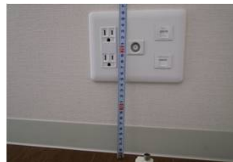
床から 20cm に差込口がある コンセントとモジュージャック
