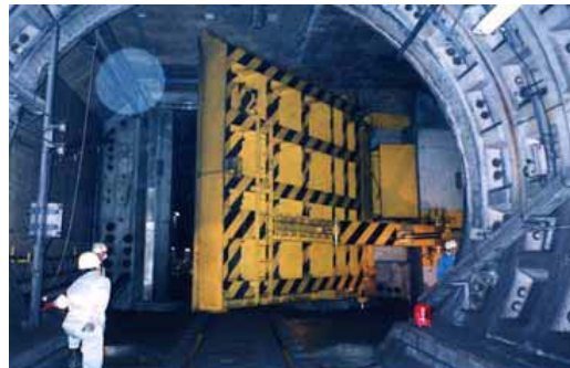
トンネル内浸水対策（トンネル内防水ゲート）
