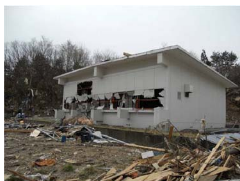
津波により被災した通信設備
