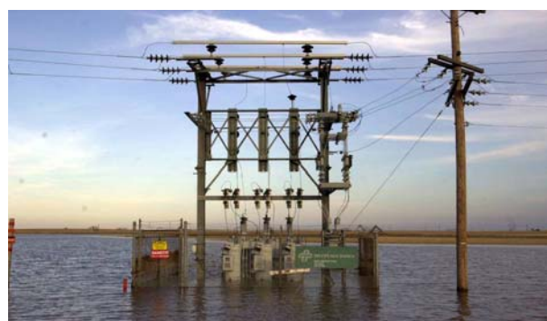
浸水による電力施設の損傷
