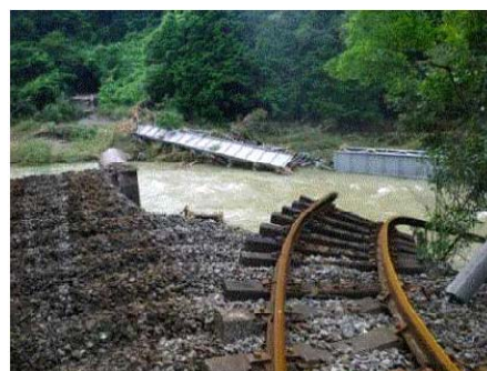
平成22年豪雨による JR美祢線の橋梁流出状況 120)
