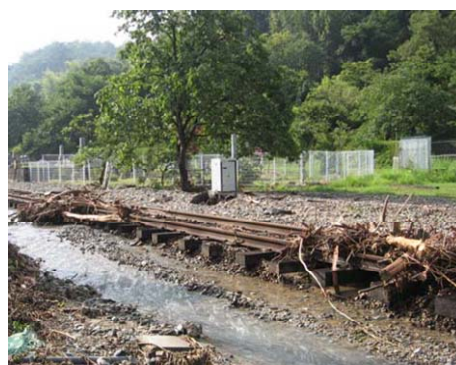
平成21年豪雨による JR姫新線の盛土流出状況
