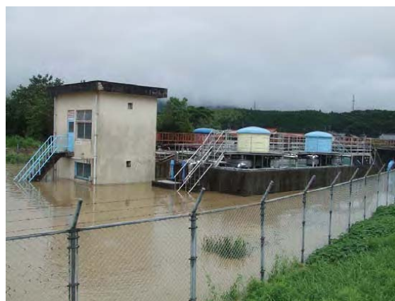
冠水して一面泥水に浸った鴨庄浄水場 132)
