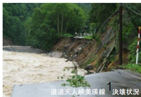
平成22年豪雨による道路寸断状況
