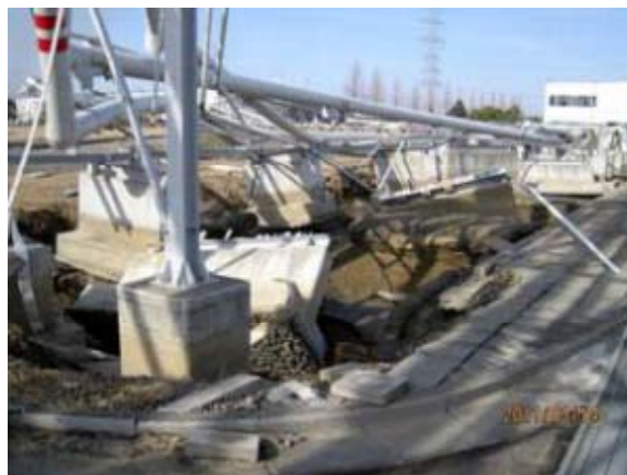
製造設備被害状況（配管・架構） 128)
