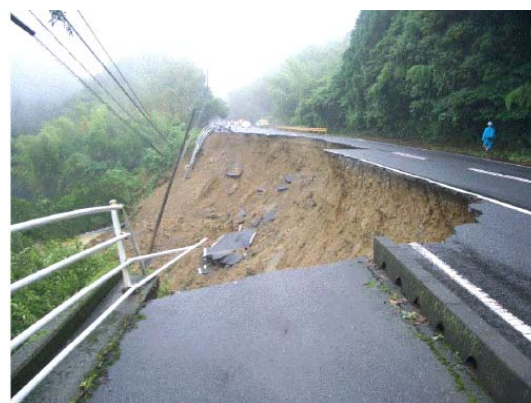
平成22年豪雨による法面崩壊状況
