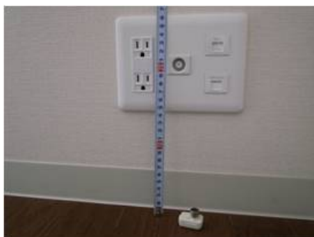
床から 20cm に差込口がある コンセントとモジュージャック
