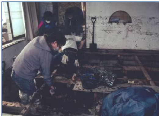
ボランティアに床下の泥撤去を依頼
