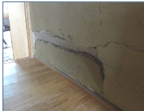
内壁が未補修のまま
