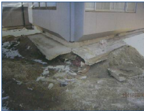
基礎がえぐられ家が傾いた
