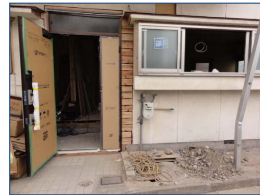
業者が忙しく、復旧が完了しない。
