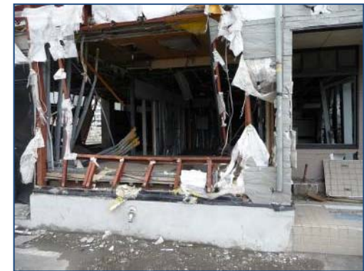
壁内の鉄骨がむき出しになった
