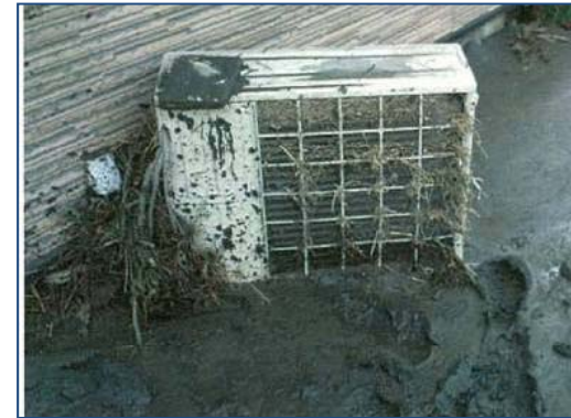
室外機が故障し、室内のエアコンも併せて交換が必要
