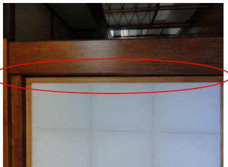
木製建具の枠が変形し、隙間が生じて開閉しにくくなった事例
