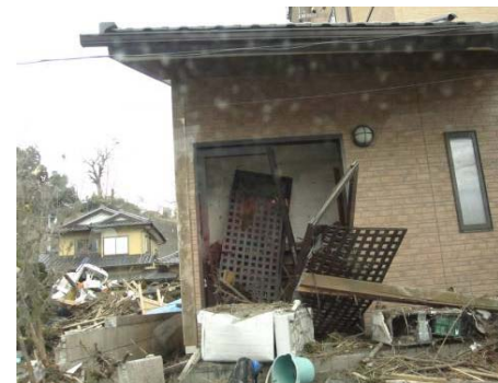
玄関の扉が破壊された事例
