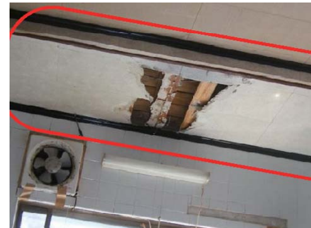
石膏ボードが吸水・膨張している
