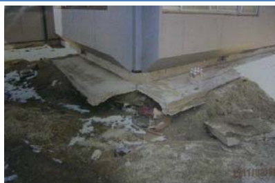
地盤がえぐられ、基礎が浮いた状態
