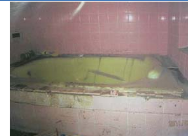
浴室のタイルが破損
