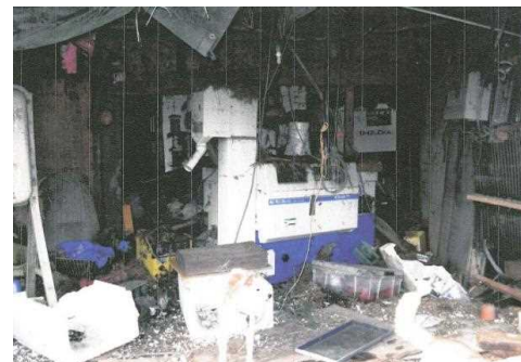
浸水深3mで被災した機械類 (床に直接設置してある機械類はほぼ全水没しており修理での再稼働は不可能)
