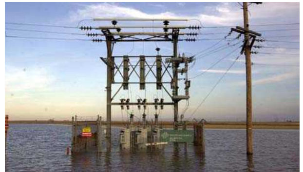
浸水による電力施設の損傷
