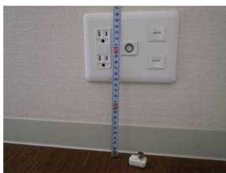
床から 20cm に差込口がある コンセントとモジュージャック
