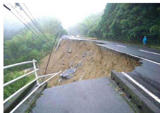
平成22年豪雨による法面崩壊状況
