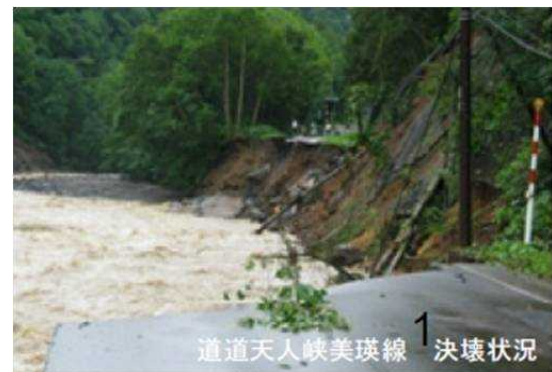
平成22年豪雨による道路寸断状況
