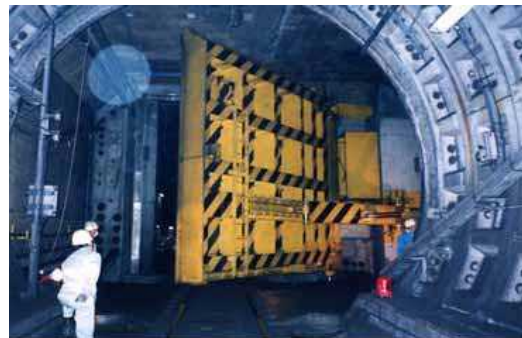
トンネル内浸水対策 105) (防水ゲート)
