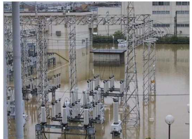
浸水による変電所の冠水
