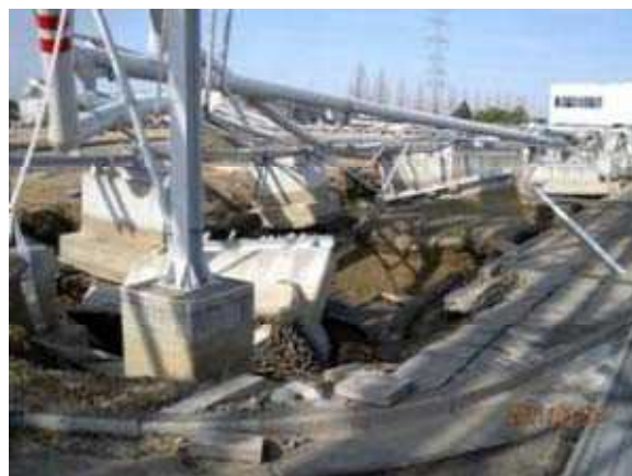
製造設備被害状況（配管・架構） 122)
