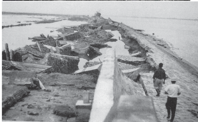
海岸堤防の被災状況
