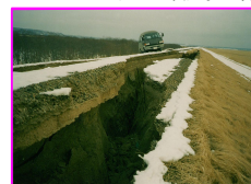
平成5年釧路沖地震 (堤防の被災状況)
