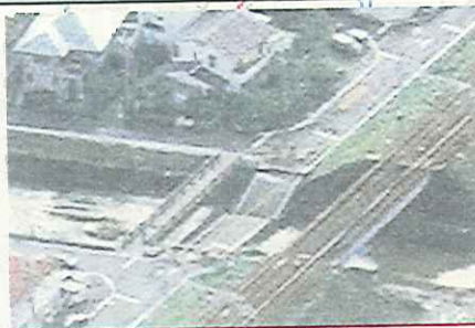
三河橋落橋(竜泉寺川)
