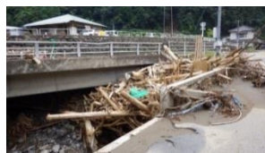
橋梁に集積する流木
