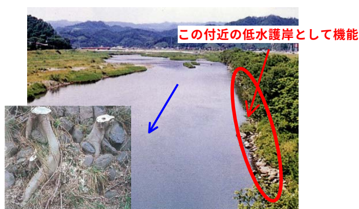
写真 4.2.1 護摩土手の法面の石積と見られる跡と 石を抱き込んだヤナギの根(稲常橋上流)
