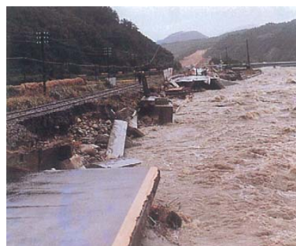
写真 4.1.1 護岸の崩壊により流出した道路
