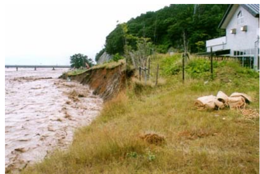
堤防欠壊状況（糸魚川市大野地先）
