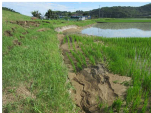
基盤漏水(吉井川右岸 13K000 付近)
