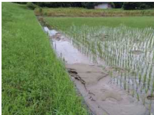
基盤漏水(吉井川右岸 8K400 付近)
