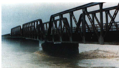
福井市高屋付近高屋橋（県道福井三国線）の橋脚が洗掘のため傾いた
