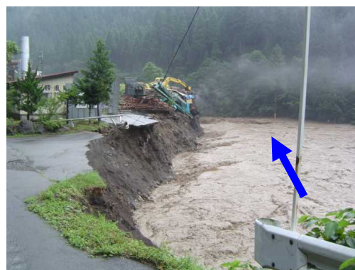
河岸侵食状況（池田町持越）
