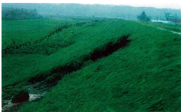
米原築堤被災状況
