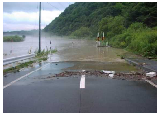
町道穂別豊田線浸水状況
