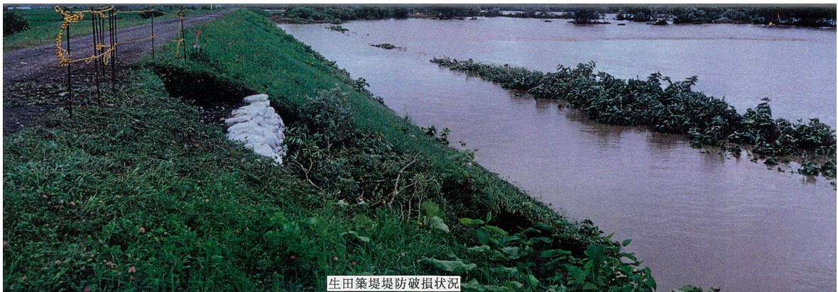
生田築堤堤防破損状況
