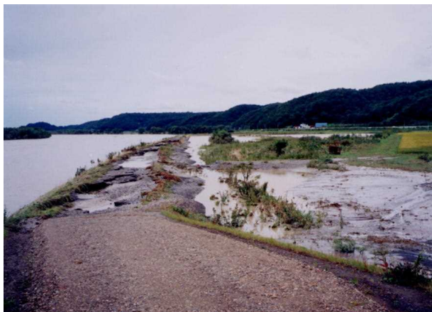
春日管理用道路被災状況
