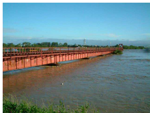
鶴川鉄道橋出水状況
