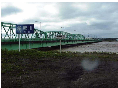
沙流川橋出水状況
