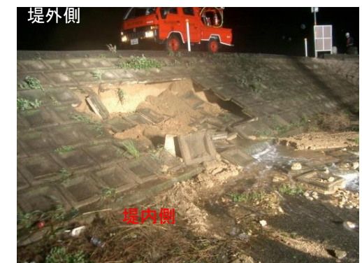
岡山県管理 海岸堤防被災状況(百間川左岸海岸堤防)
