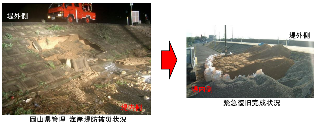
平成 16 年 8 月洪水における高潮の状況(岡山県管理海岸堤防被災状況)
