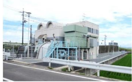
倉安川排水機場 (平成11年度整備、平成26年度ポンプ増設)
