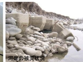
河岸の被災状況
