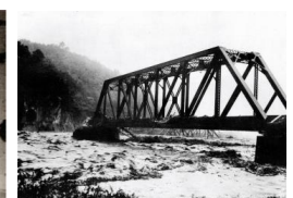
一部流失した能美電鉄の鉄橋 出典: 石川県大水害写真(石川県)
