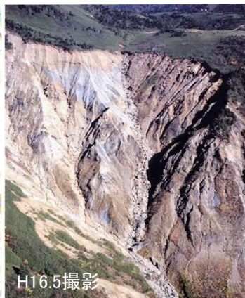
H16.5撮影 牛首川源頭部の荒廃状況
