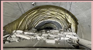
写真① 国道249号大谷トンネル内の崩落
