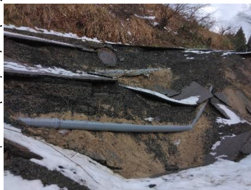
浄水場から配水池へ向かう水道管の破損・露出（輪島市）
