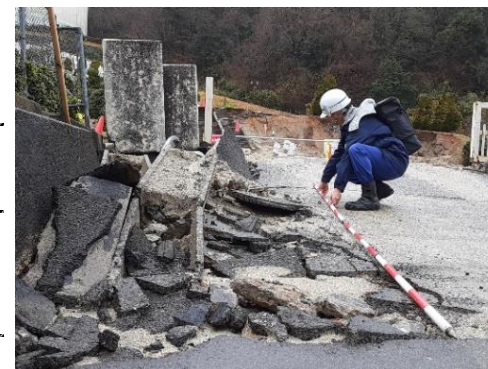
岩屋浄水場の被災（七尾市）
