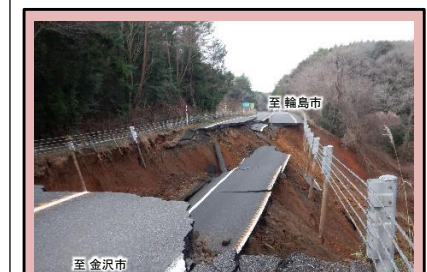
写真⑤ 能越自動車道の道路崩壊
