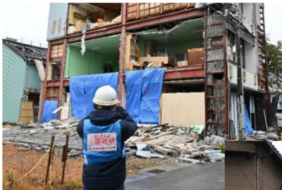
建築物の損壊状況（七尾市）
