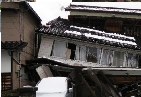
木造建築物の倒壊状況（穴水町）
