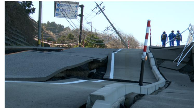
国道249号道の駅千枚田付近（輪島市）
