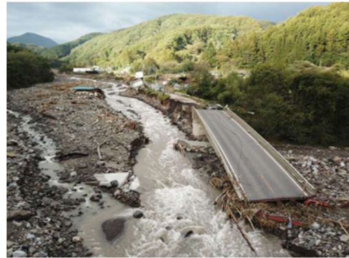
図 2-12 国道 144 号流失（鳴岩橋落橋）
