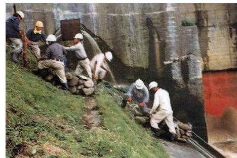
漏水状況(昭和57年9月洪水)
