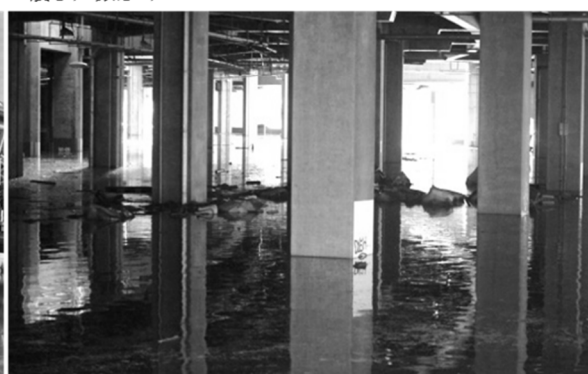
日産スタジアム下部の浸水状況
